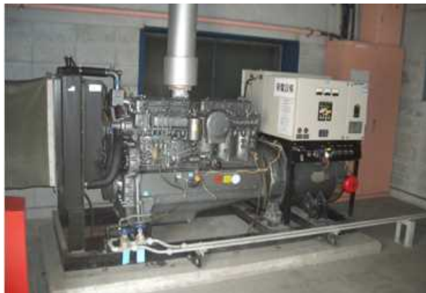
▲筑波工場 給水用非常用発電機
